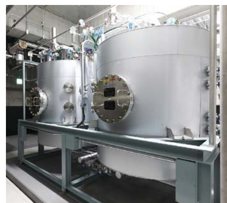
タカラバイオ本社事業所の廃液滅菌システム
