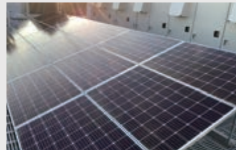
本社事業所に設置した太陽光パネル
